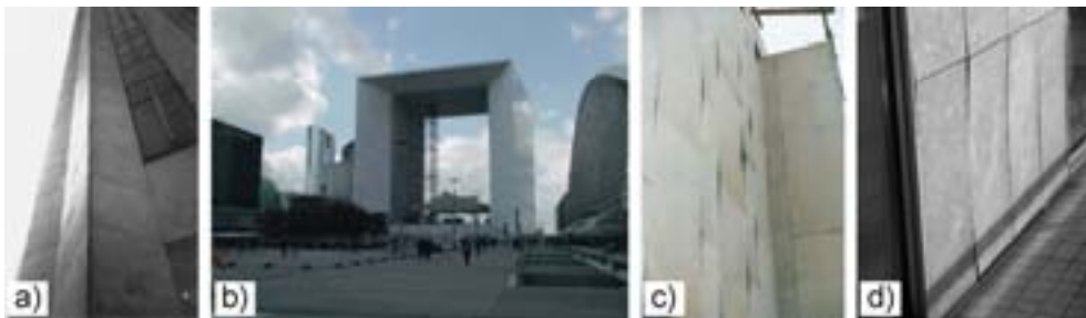
Abb. 2.8: Prominente Beispiele von Gebäuden mit verbogenen Fassadenplatten: a) Das Amoco Building in Chicago (aus Logan 2004), b) der Grande Arche de la Défense in Paris, c) die Finlandia Hall in Helsinki (um 1999) und d) das St. Marien-Hospital in Lünen (Balkon).
